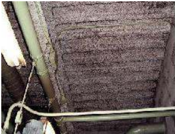
石綿含有吹付けロックウール
